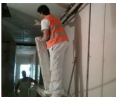
Disposición de plataforma sobre borriquetas (aunque ausencia de casco de seguridad)
