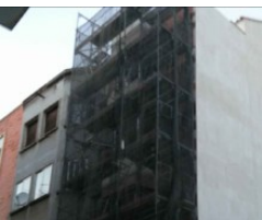
Correcta disposición de andamio tubular europeo para ejecución y protección en fachadas.
