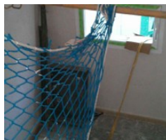
Señalización del riesgo de caída a distinto nivel con un medio inadecuado
